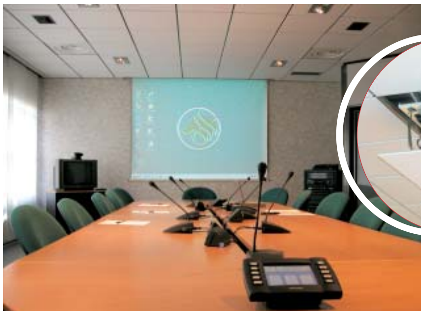
Impianto per sala riunioni con videoconferenza e videoproiettore a pantografo
